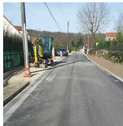
La finition des entrées rue des Mathurins avant le revêtement de la voirie prévu en mai/juin
